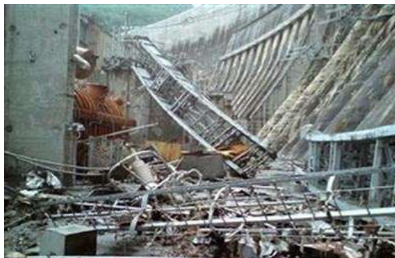
Accident sur un barrage hydroélectrique de Sibérie (Source lavenir.net)
